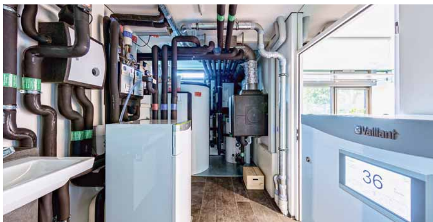
Das innovative Energiemanagement eHOME von Vaillant steuert die Energieströme im Haus - bis zum „Betanken“ des E-Mobils.
